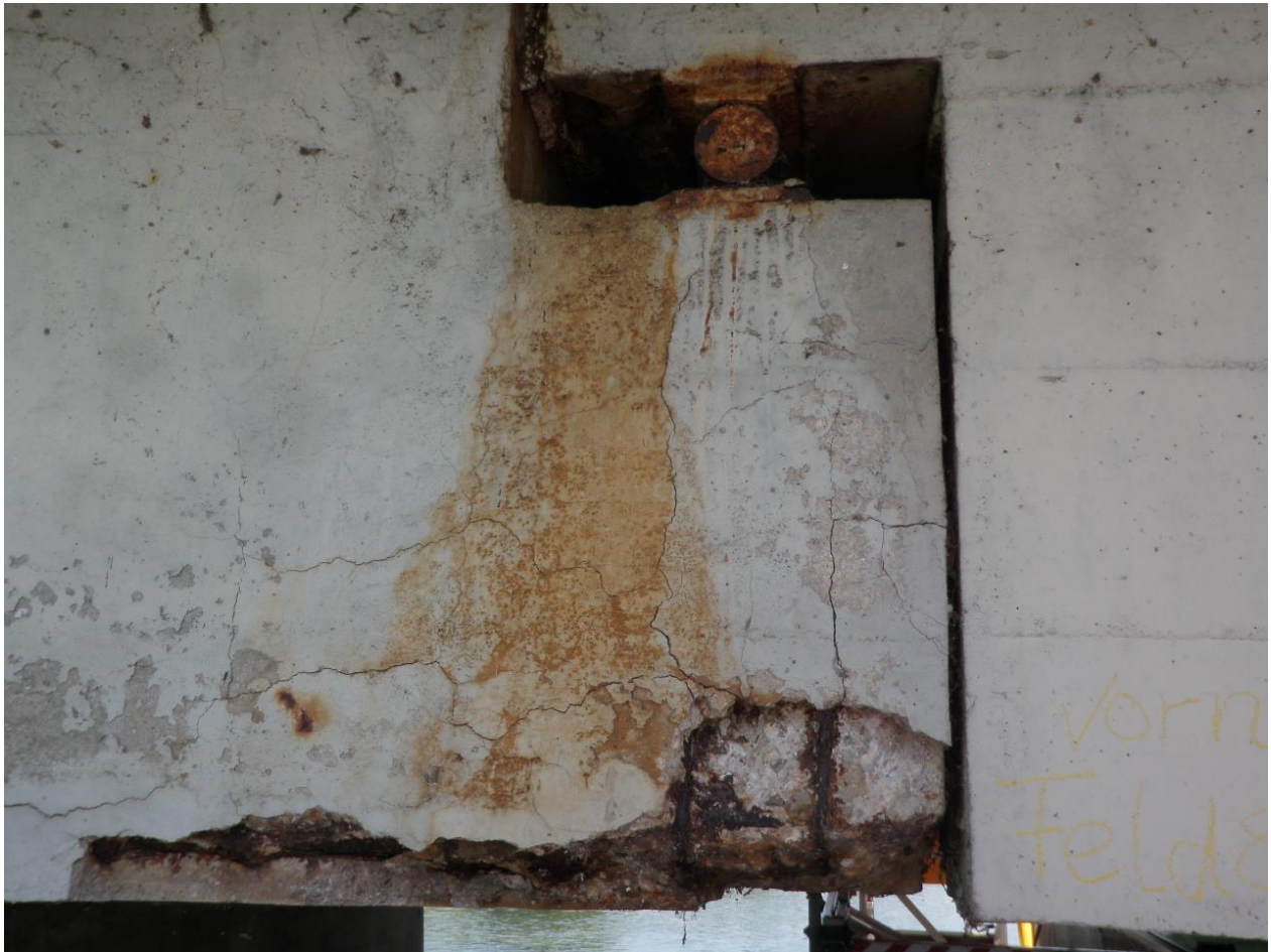
Bild: Korrosionsschaden am Bauwerk
